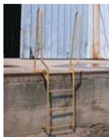
W4 Permanent Dock Ladder
